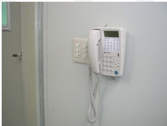
圖31 壁掛式通訊設備
