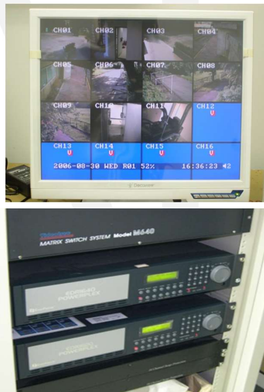
圖29 錄影監視設備
