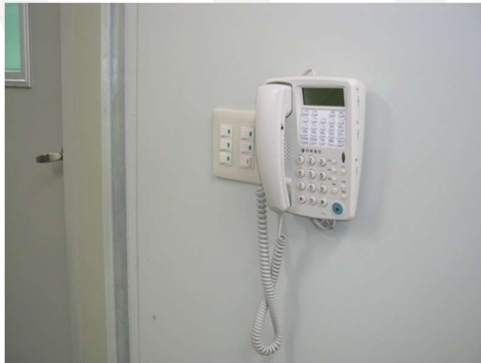
圖31 壁掛式通訊設備
