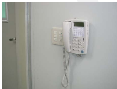
壁掛式通訊設備
