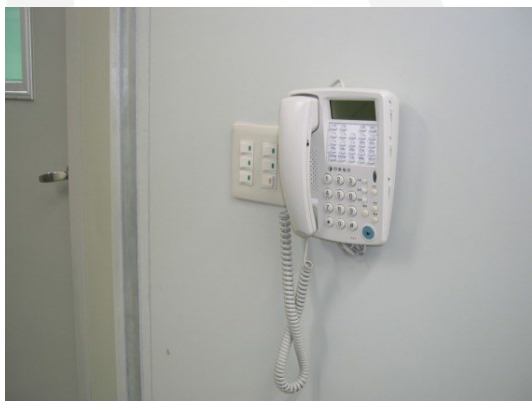
圖30 壁掛式通訊設備
