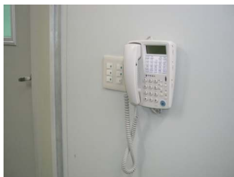
壁掛式通訊設備
