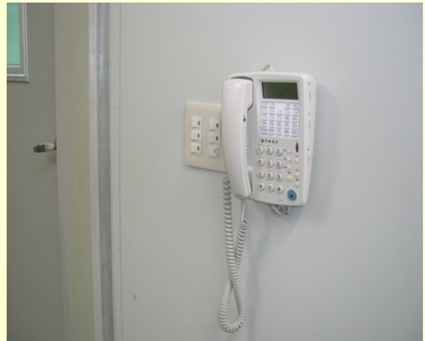
圖30-壁掛式通訊設備
