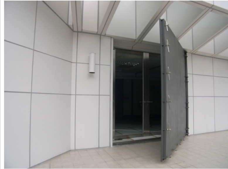
圖2 國家檔案典藏場所正門口防水閘門
