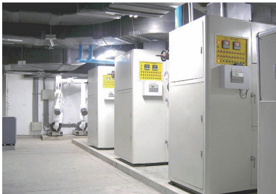
圖 34 恆溫恆溼空調設備
