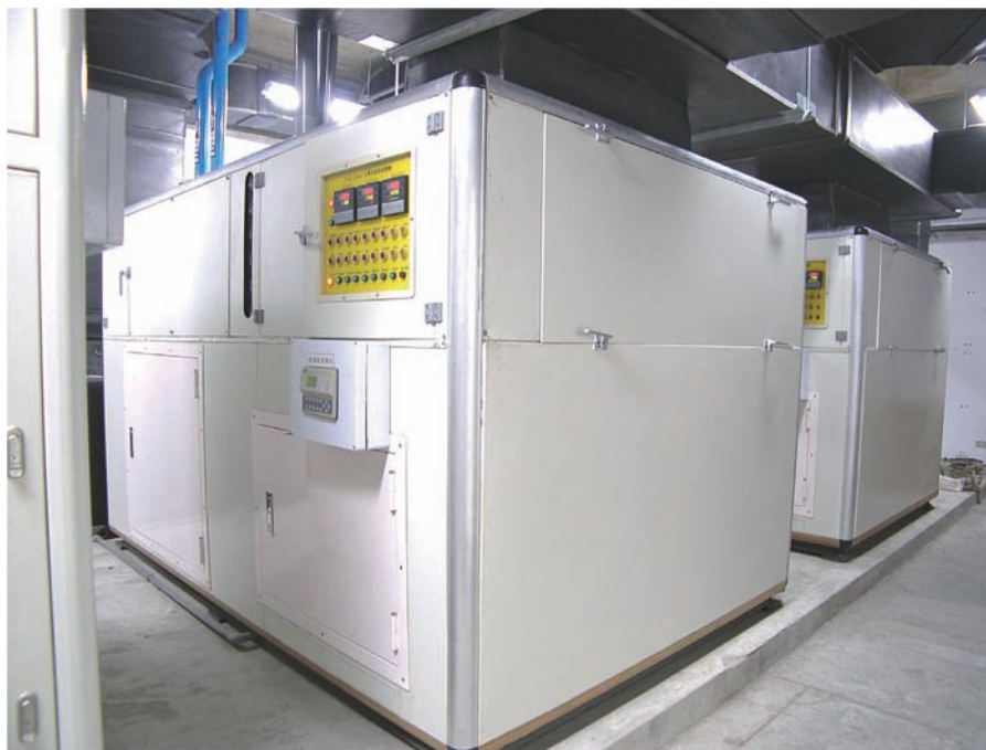
圖 33 化學除溼空調設備
