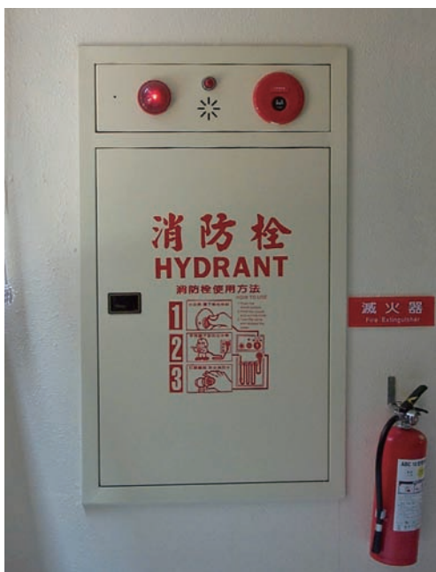
圖 55 一般消防消防栓箱及手提式滅火器
