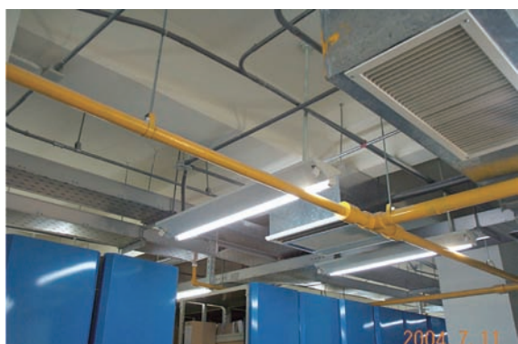
圖 50 自動氣體滅火系統管線 (黃色)
