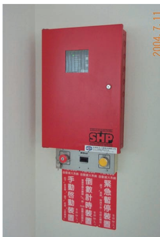
圖 53 自動氣體滅火系統控制箱
