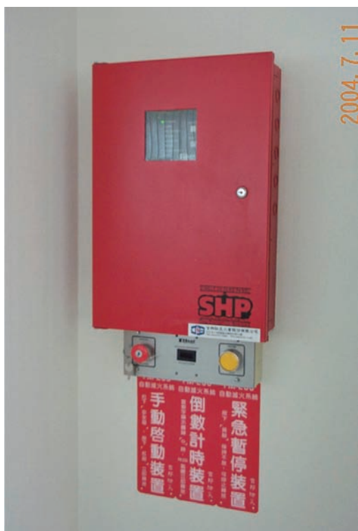
圖 53 自動氣體滅火系統控制箱
