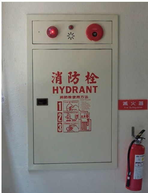
圖 55 一般消防消防栓箱及手提式滅火器
