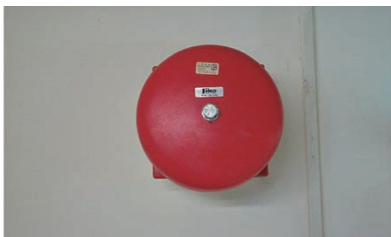
圖 49 自動氣體滅火系統警報器
