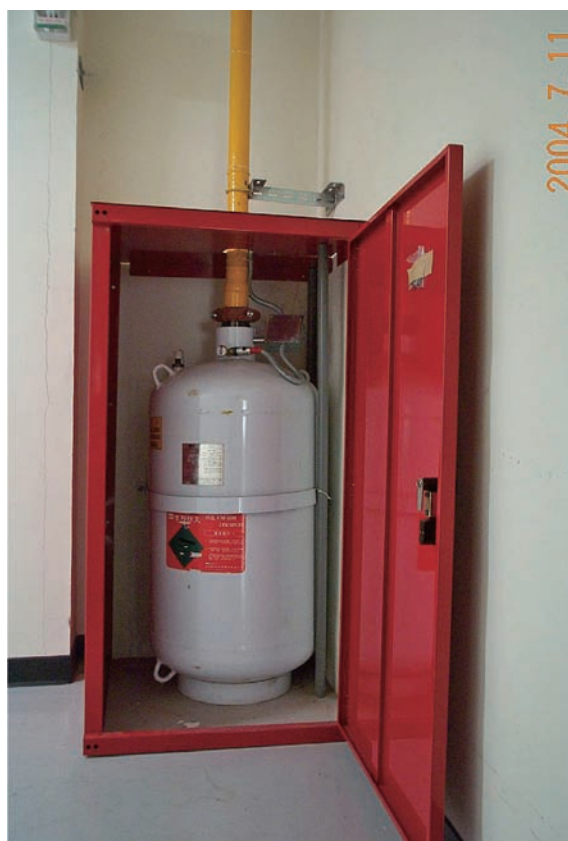
圖 51 自動氣體滅火系統鋼瓶
