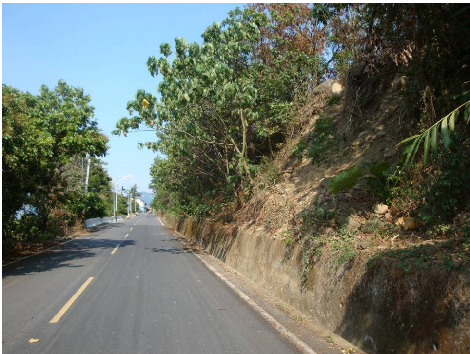
圖 8 高 128 縣道排水溝設計不良無法有效排水
