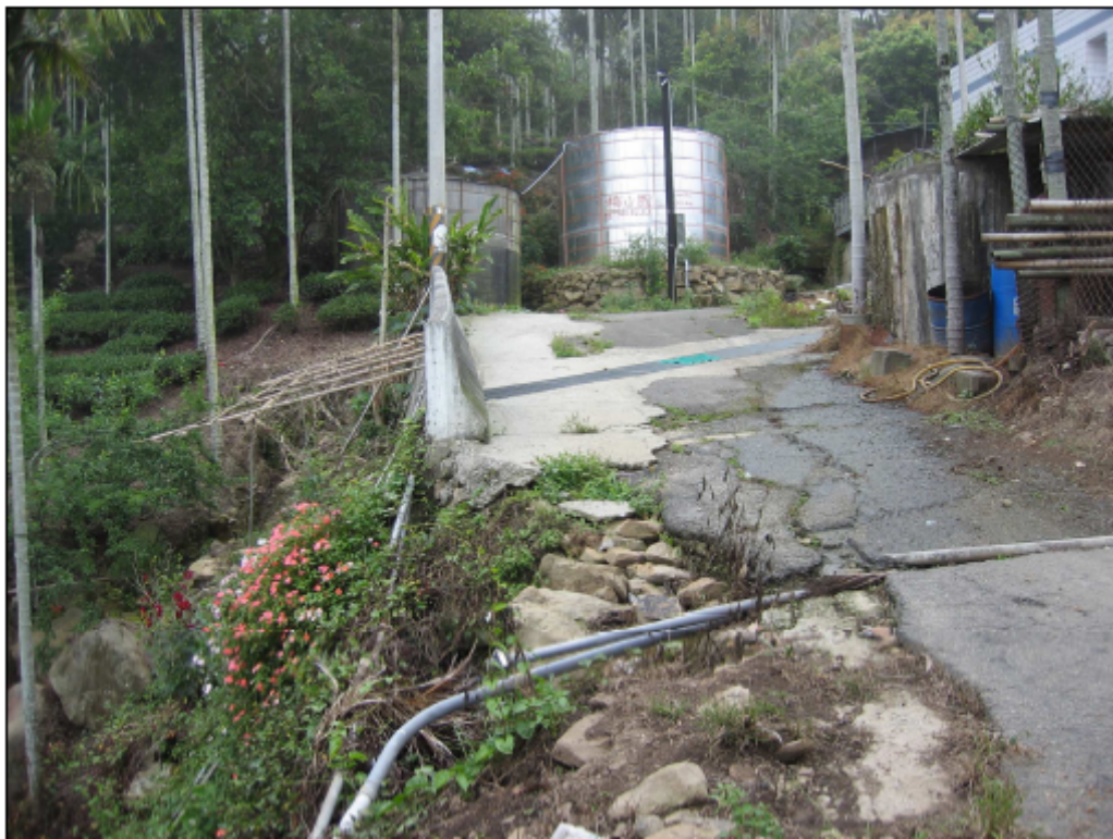
照片說明：9 鄰 8 號上邊坡地表逕流集中，匯入 8 號建物附近排水溝。
