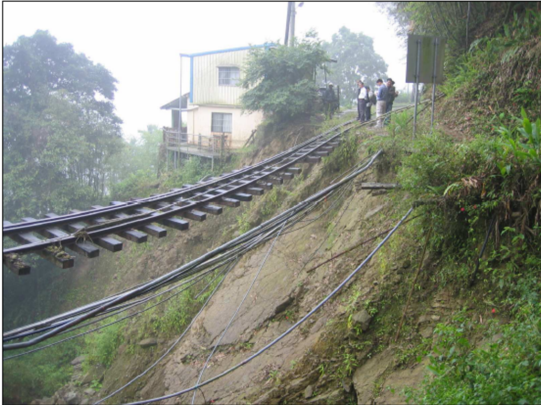
照片說明：地表逕流集中沖蝕，造成鐵路路基流失。
