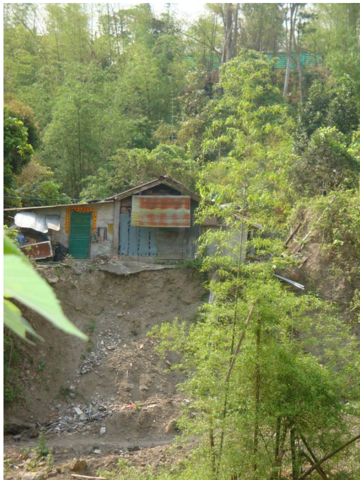
圖 4 鄰近溪畔建物基礎流失
