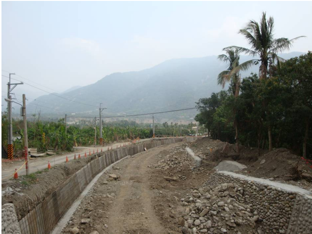
圖 13 柴頭溪河床明顯淤積，雖進行清淤，但土石量仍龐大
