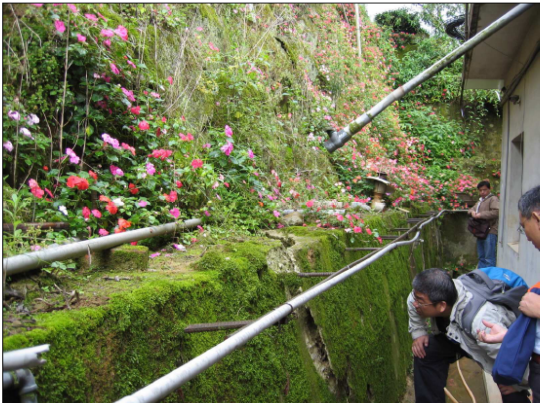
照片說明：房舍後方擋土牆破裂。
