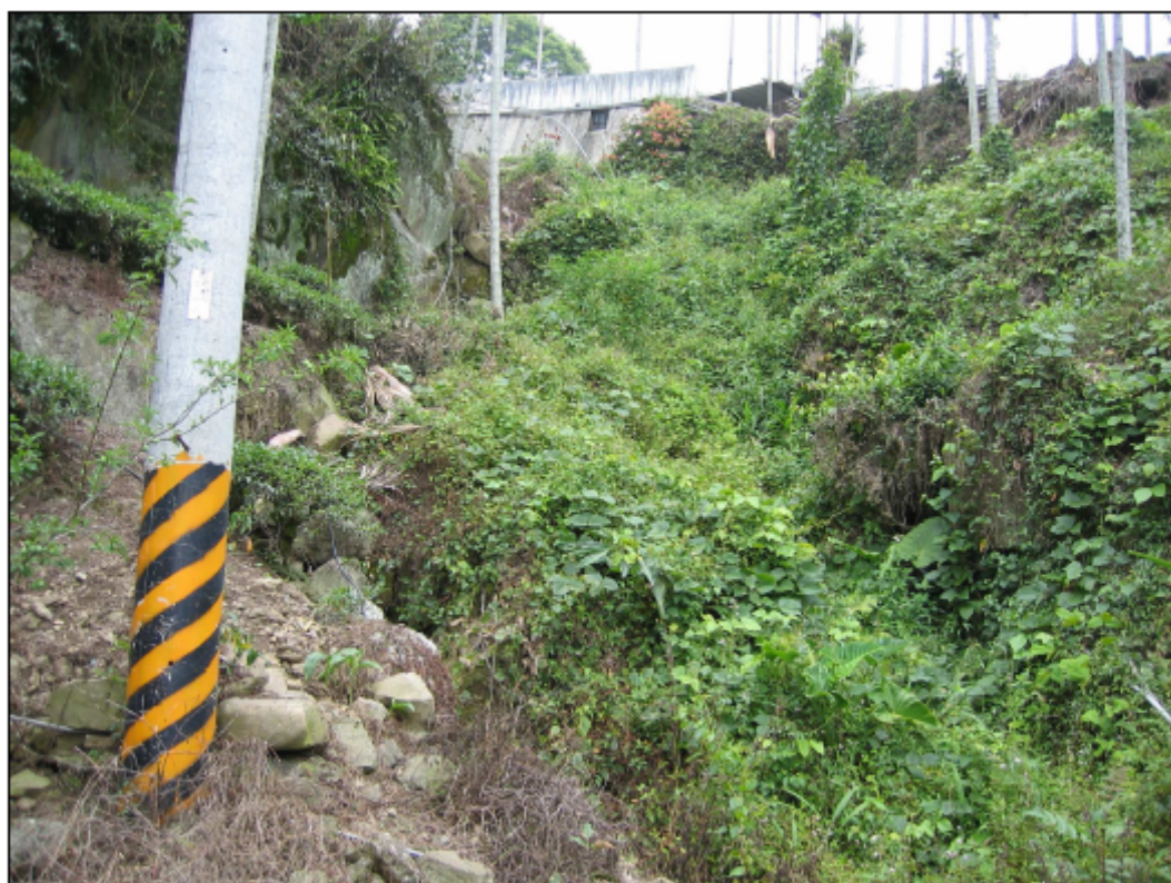
照片說明：9 鄰 8 號上邊坡地表逕流集中，匯入 8 號建物上方排水溝，並造成電表嚴重沖蝕。
