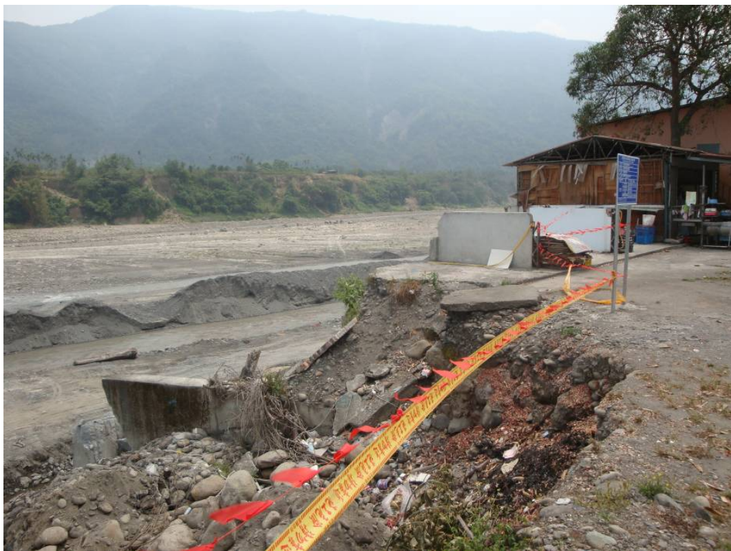
圖 14 荖濃溪右岸濟公廟附近區域(21、26 鄰)，莫拉克風災損害情形
