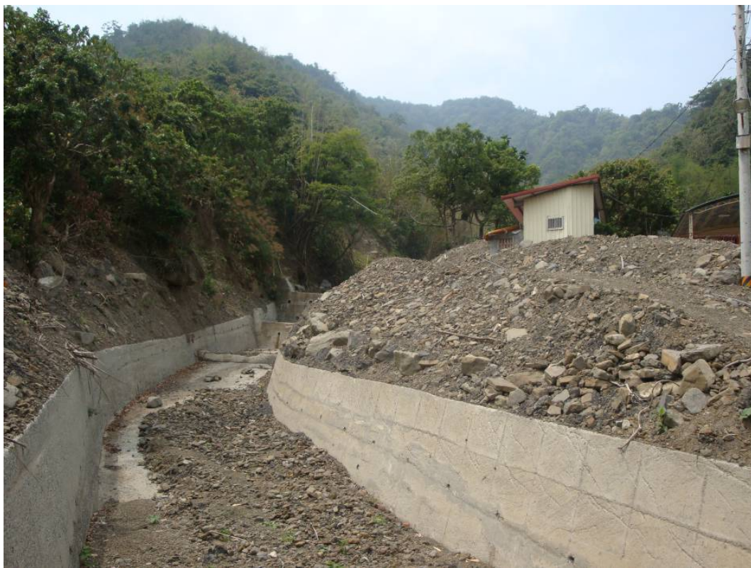
圖 10 木瓜坑河床明顯淤積，雖進行清淤，但土石量仍龐大
