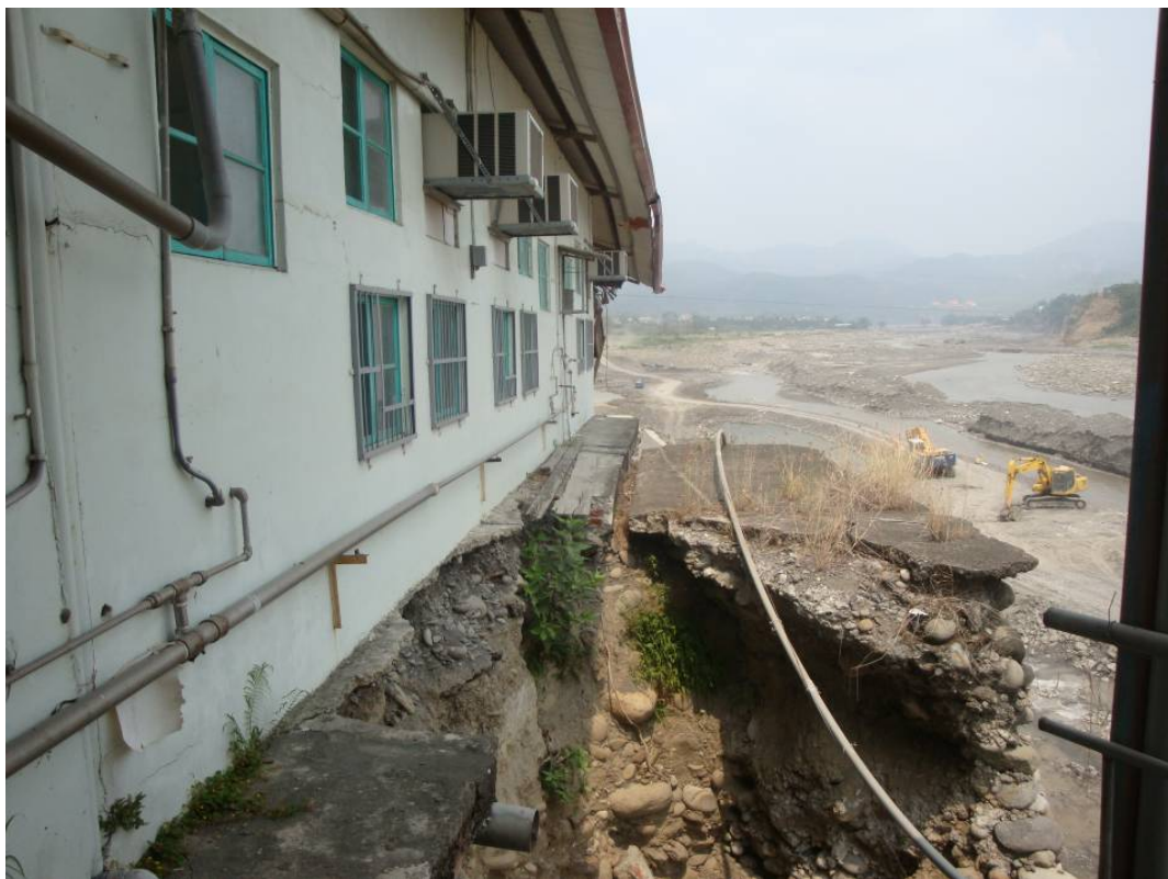
圖 16 荖濃溪右岸濟公廟附近區域(21、26 鄰)，莫拉克風災損害情形
