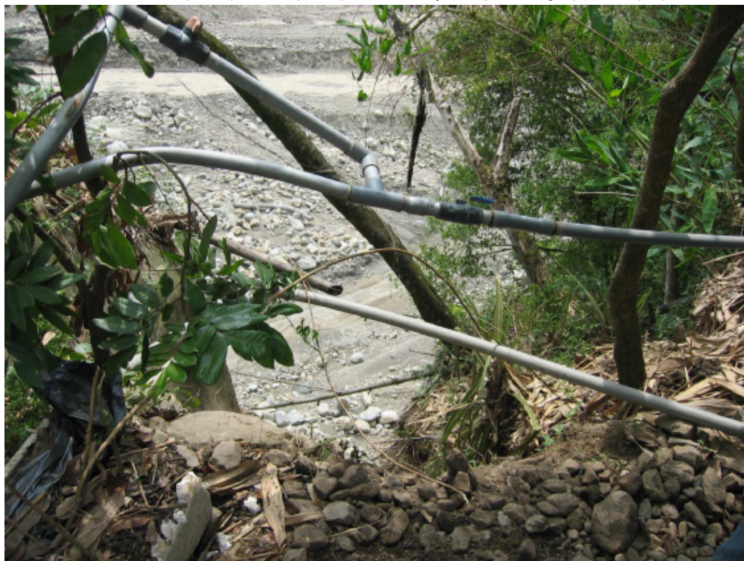
照片說明：梅山鄉太和村 3 鄰 37-2 號房舍後方下邊坡發生崩塌。
