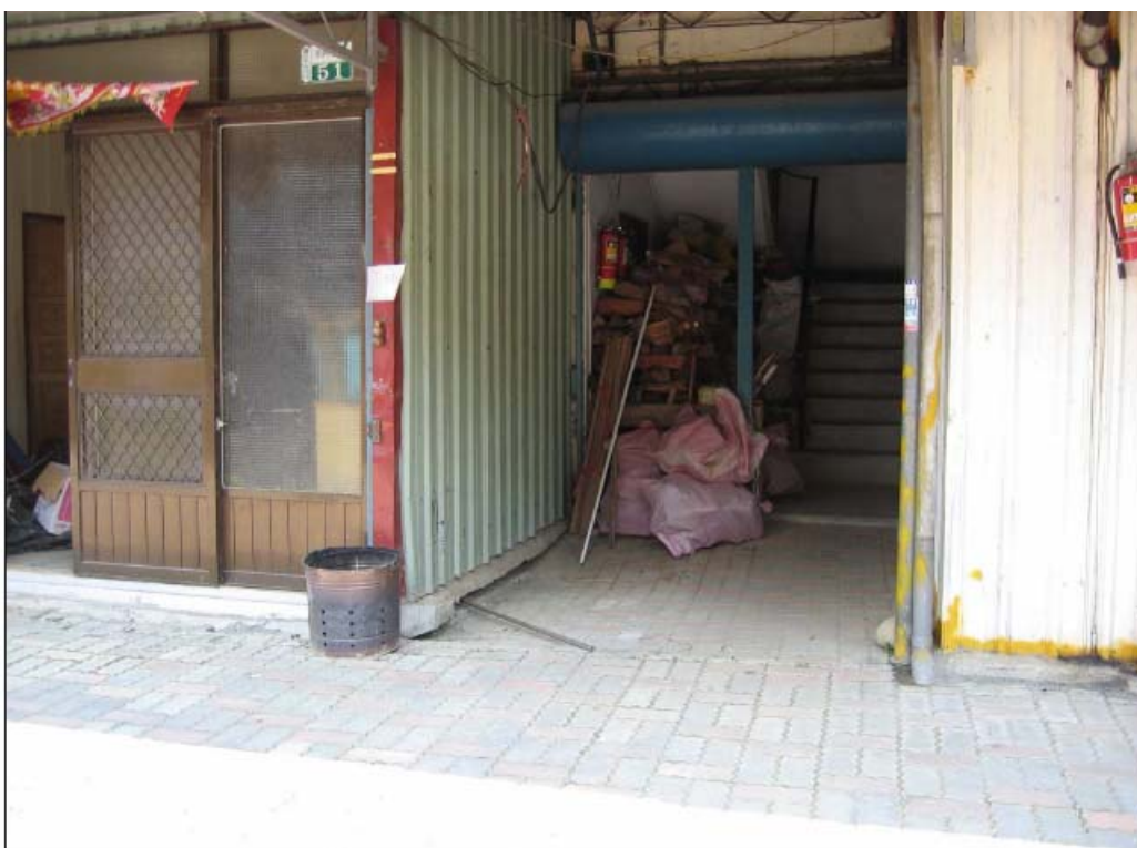
照片說明：居住地地表不均勻沉陷明顯，造成建築物地面凹陷、牆柱傾斜。
