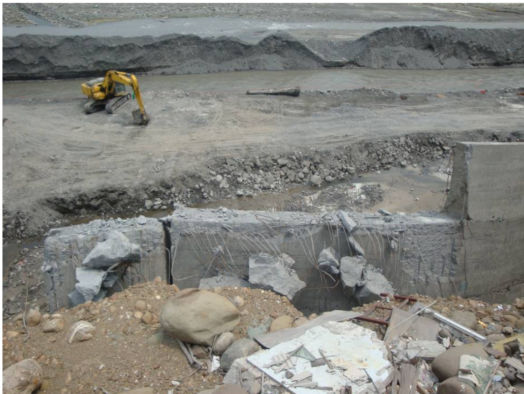
圖 15 荖濃溪右岸濟公廟附近堤岸，莫拉克風災損害情形
