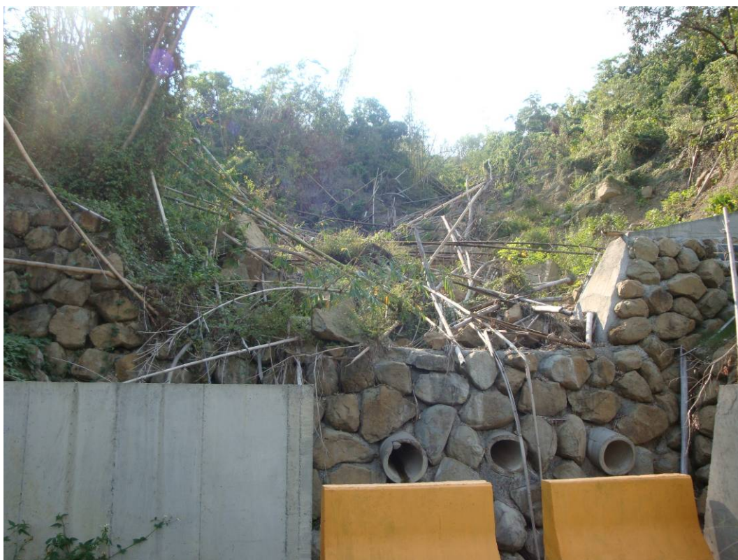
圖 8 土石流潛勢溪流(DF012)上游多處崩塌
