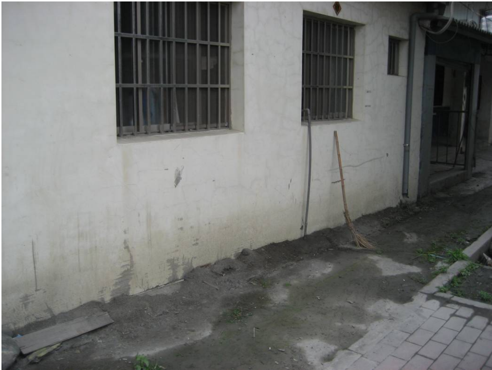
圖 7 2 鄰民房殘留淹水痕跡
