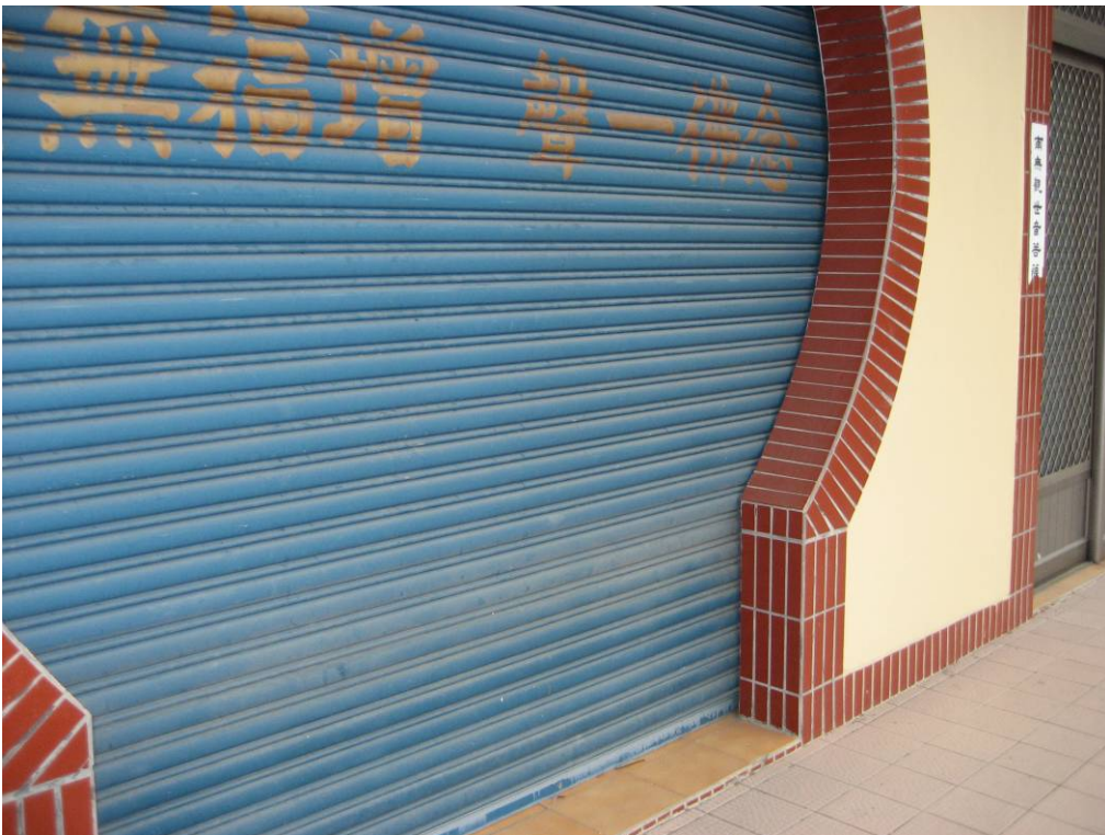
圖 6 1 鄰民房殘留淹水痕跡
