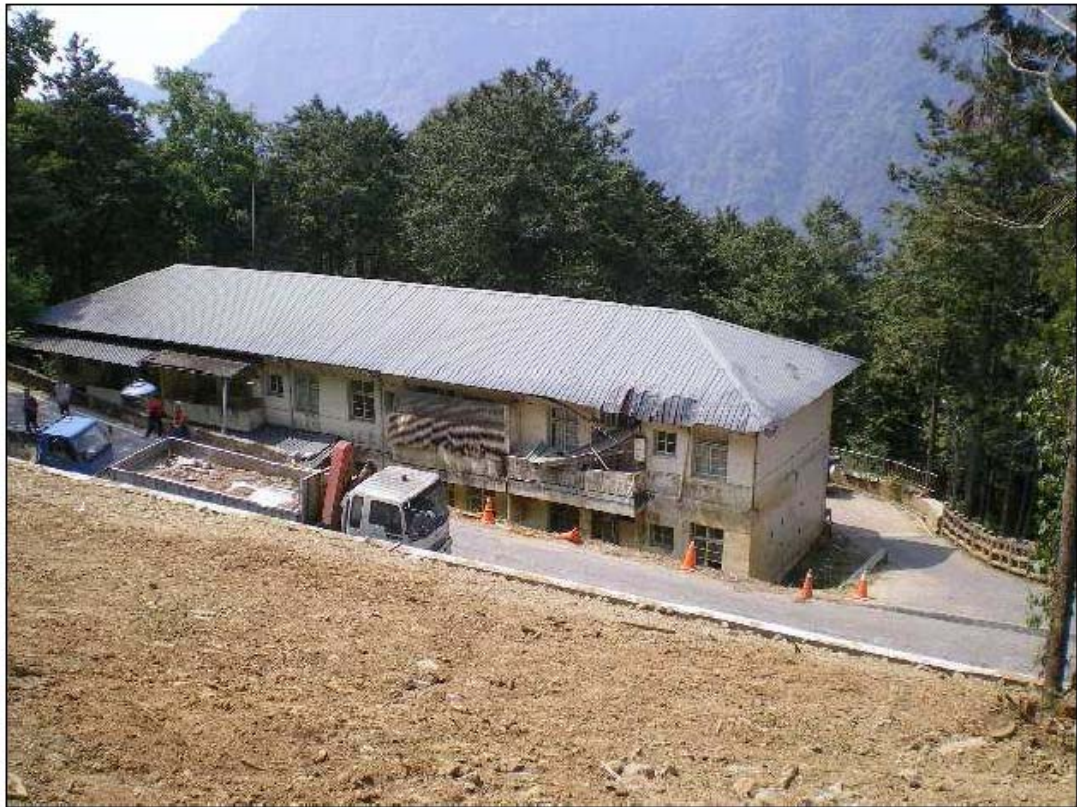
照片說明：居住地上邊坡崩塌，土石衝擊房舍造成毀損與淤積。
