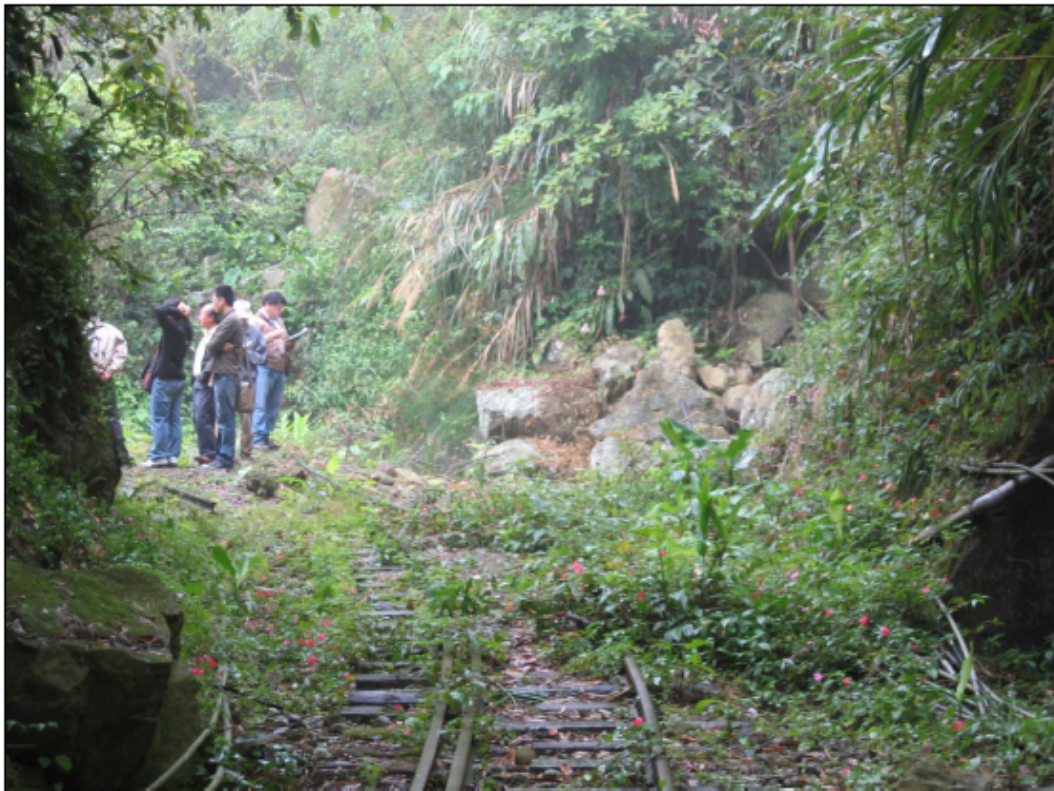
照片說：鐵路上邊坡崩塌，造成路面掩埋及流失，危及周邊住家安全。
