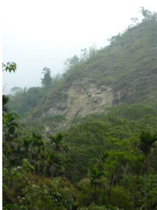
上方邊坡為順向坡有自由端出露
