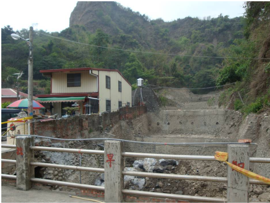
圖 12 柴頭溪河床明顯淤積，雖進行清淤，但土石量仍龐大
