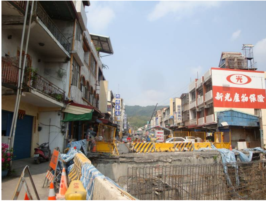
圖 3 六龜大橋目前仍在重建，18 及 23 鄰附近堤岸尚未修復
