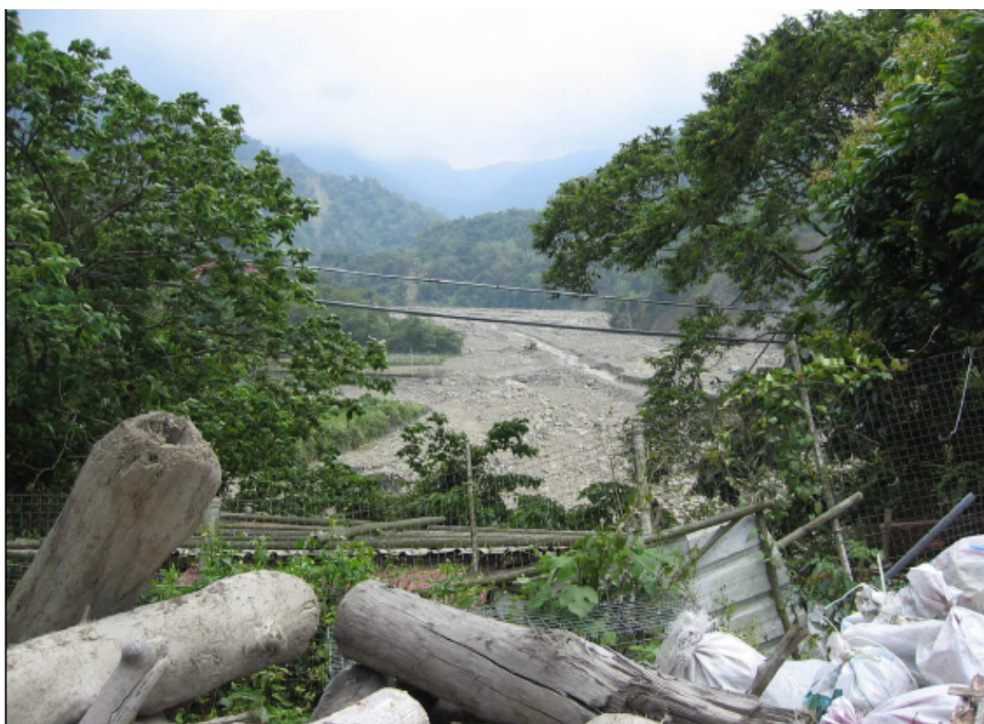
照片說明：房舍位於阿里山溪攻擊波上方，房舍後方下邊坡局部崩塌。
