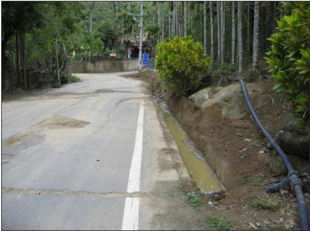
照片說明：野溪溢流水沿路面流至建築物周邊，造成淹水與土砂淤積。
