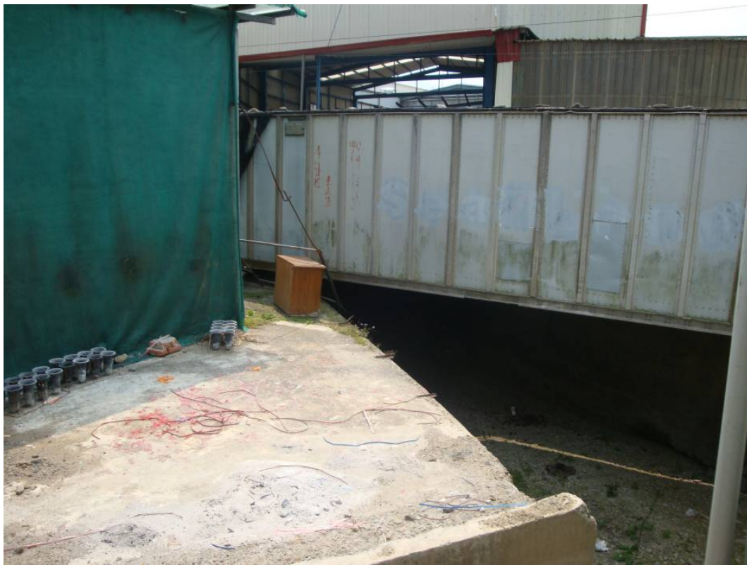
圖 7 下游 14 鄰民宅明顯佔用河道，導致河道淨高、淨寬不足
