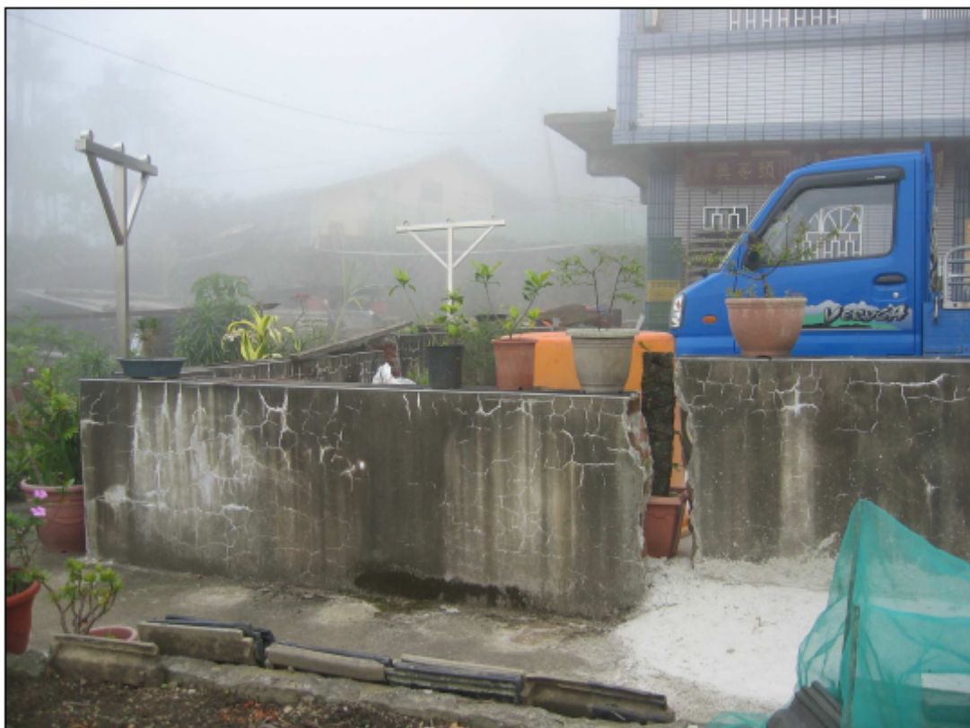
照片說明：地表嚴重破裂，房屋嚴重傾斜，牆面破裂。
