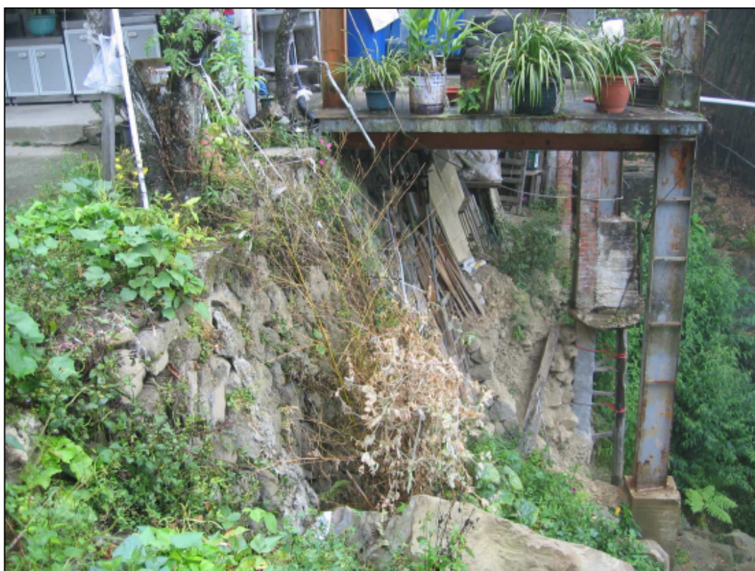
照片說明：房舍前院路面水侵入，造成下邊坡土石嚴重流失。
