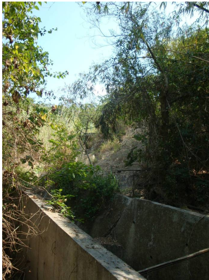
圖 5 寶隆村 11 鄰旁大排水溝因土石崩落而淤積
