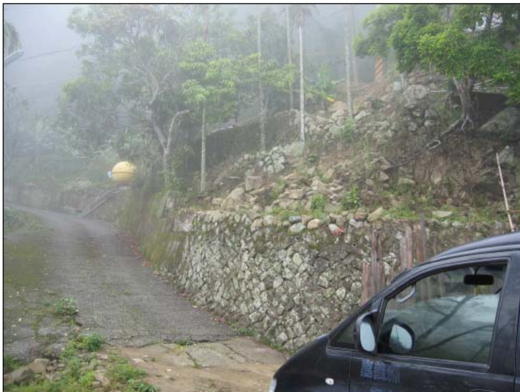
照片說明：房舍上邊坡地表逕流集中沖蝕，造成砌石坡崩塌，路面水侵入房舍前院
