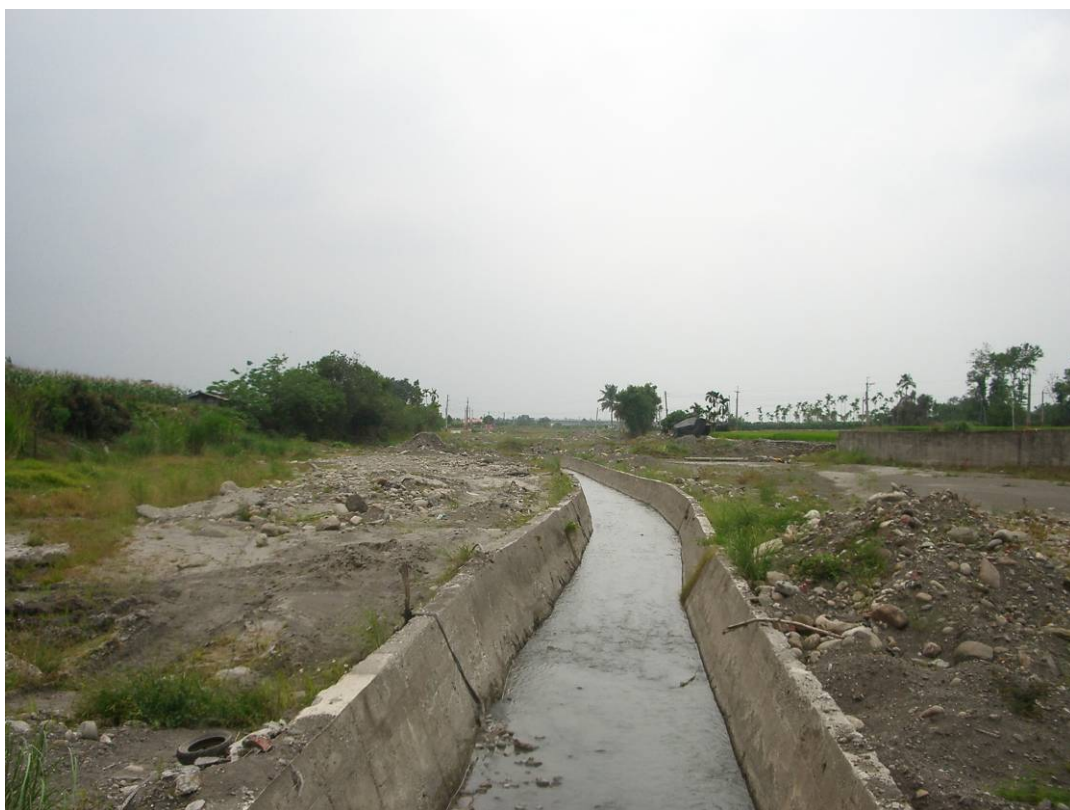
圖 4 溪埔地區(7)鄰災後清理後留下之土石
