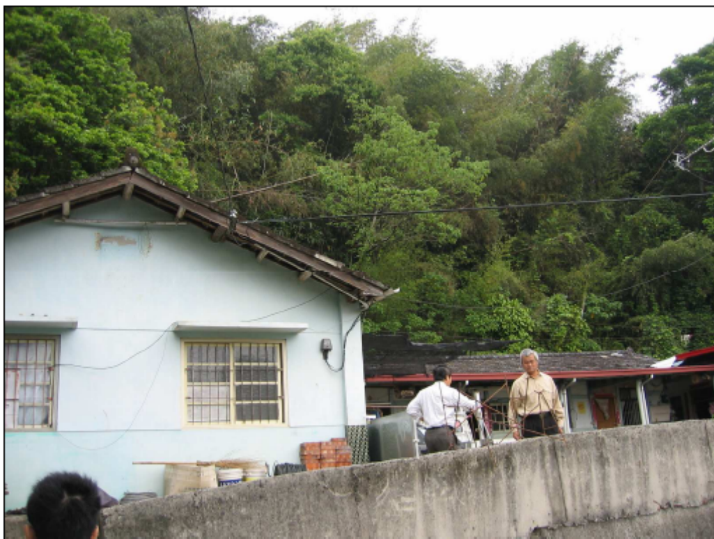
照片說明：16 號建築物後方上邊坡陡峭，樹木雜亂，坡腳突出變形。
